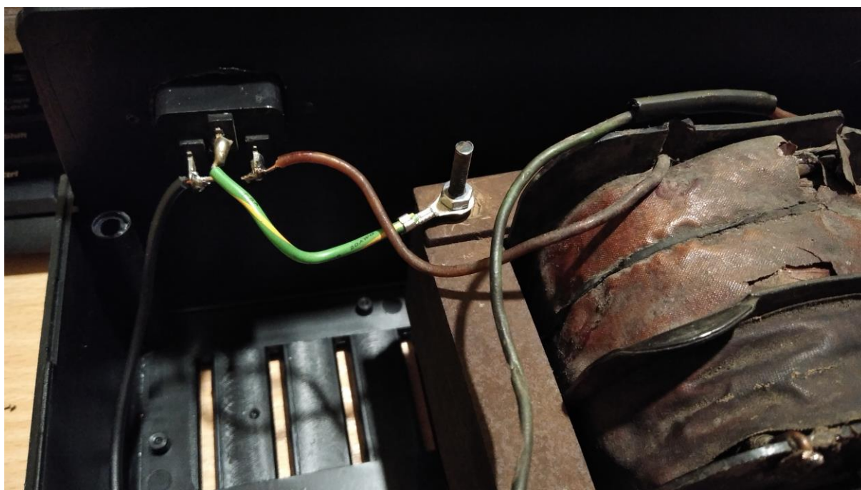
Rys. 20. Podłączony transformator do gniazda zasilającego Przewód ochronny PE został podłączony do rdzenia transformatora.
