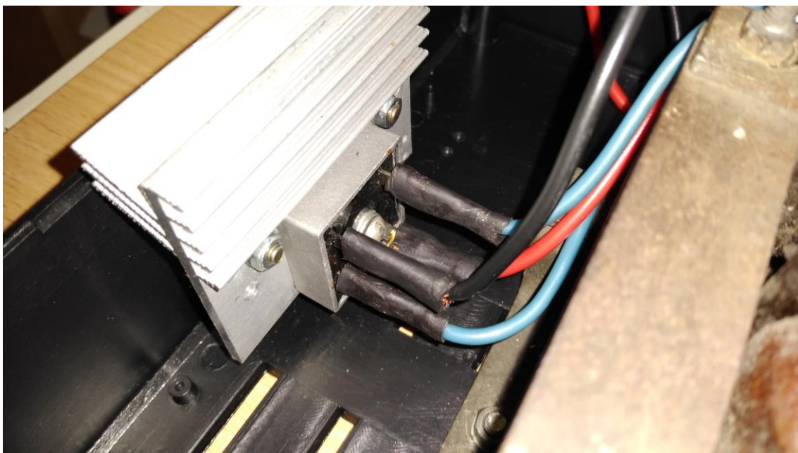
Rys. 22. Podłączony mostek prostowniczy
