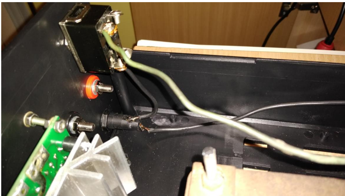
Rys. 21. Zdjęcie przedstawia podłączony bezpiecznik oraz łącznik
