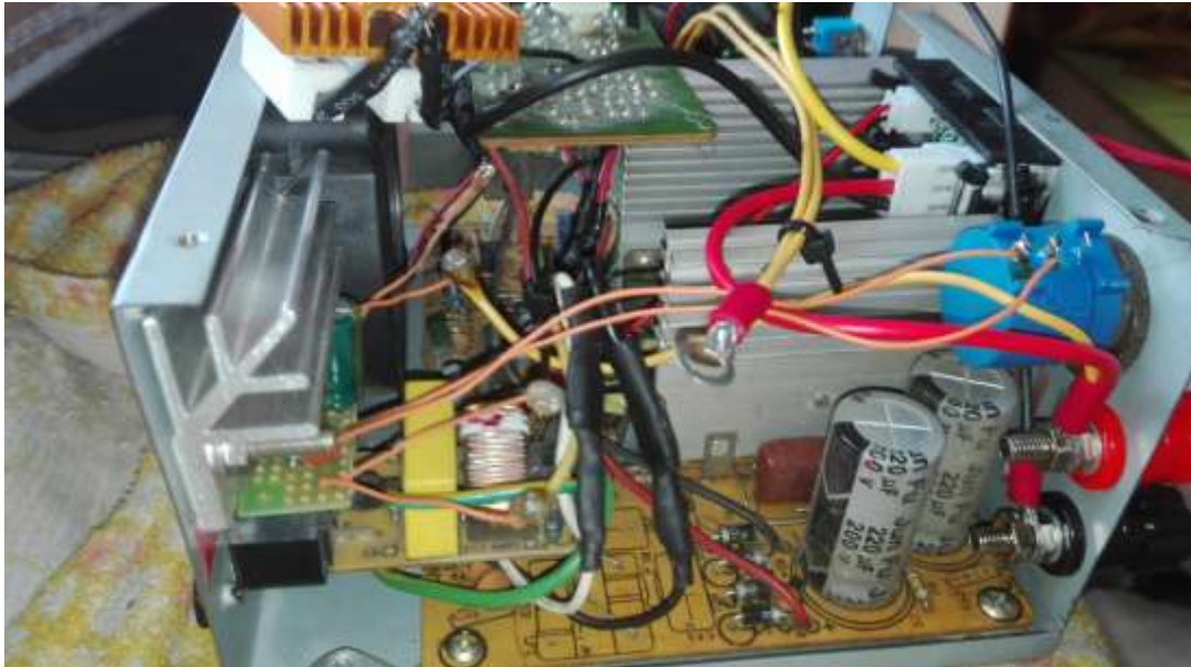
Rys. 11. Zdjęcie poglądowe przedstawiające wnętrze zasilacza.
