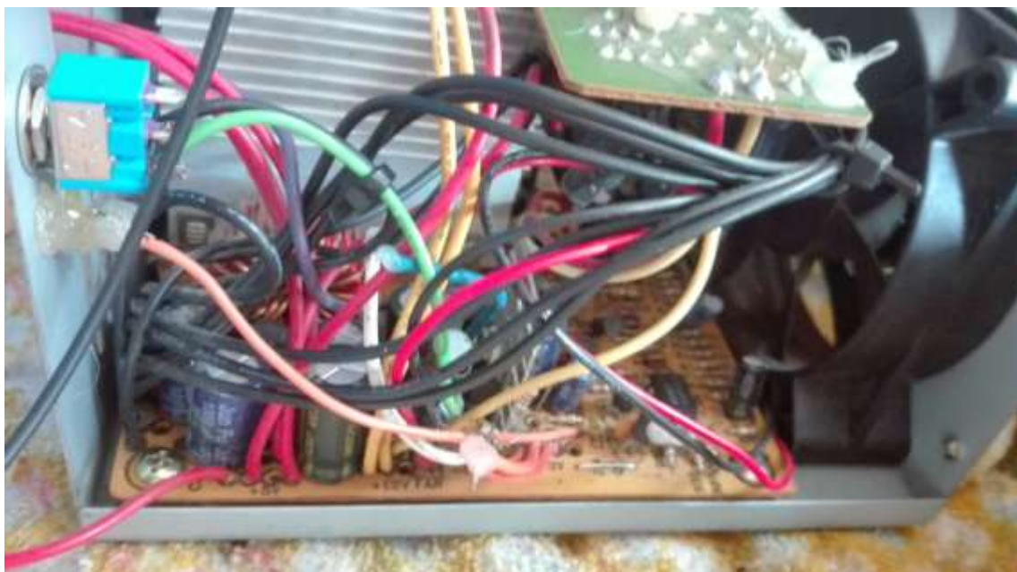
Rys. 14. Wnętrze zasilacza z widocznym włącznikiem oraz wentylatorem.
